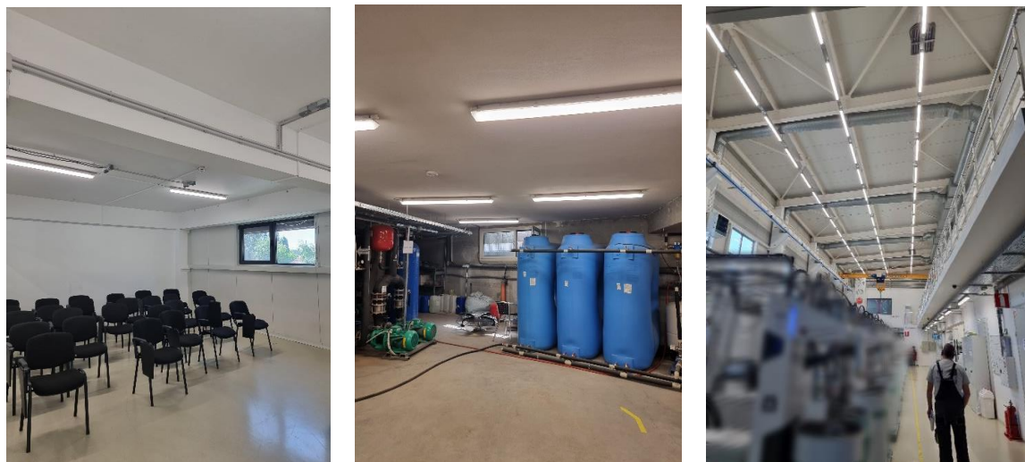
Ново осветление в производствените помещения
